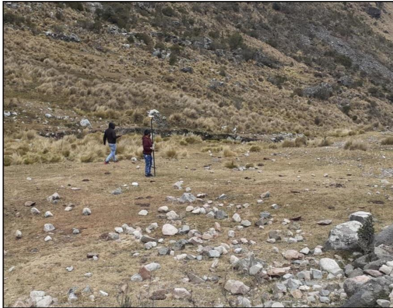
En la imagen se observa al personal técnico realizando el levantamiento con GPS diferencial la línea de conducción de la localidad de Chuparo.
