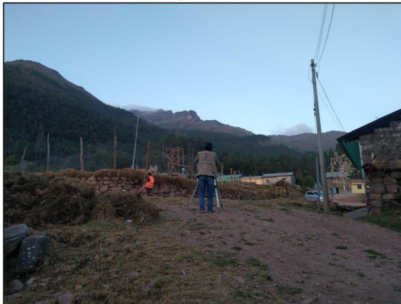
En la imagen se observa al personal técnico y su cuadrilla para realizar el correspondiente levantamiento topográfico de la localidad de Quispimarca.
