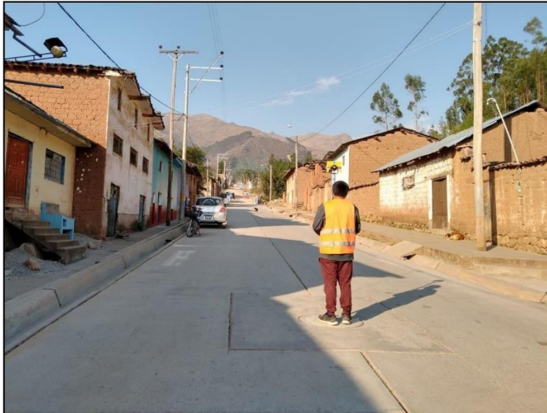
En la imagen se observa al personal de topografía realizando el levantamiento de puntos detallados de la calle en la localidad de Vista Alegre.
