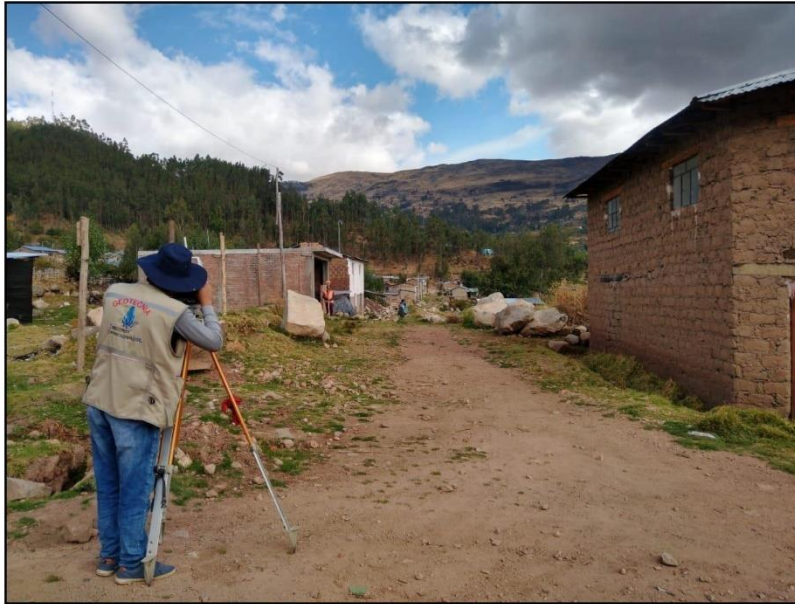
En la imagen se observa al personal de topografía, realizando el levantamiento de puntos detallados de la calle, en la localidad de Vista Alegre.
