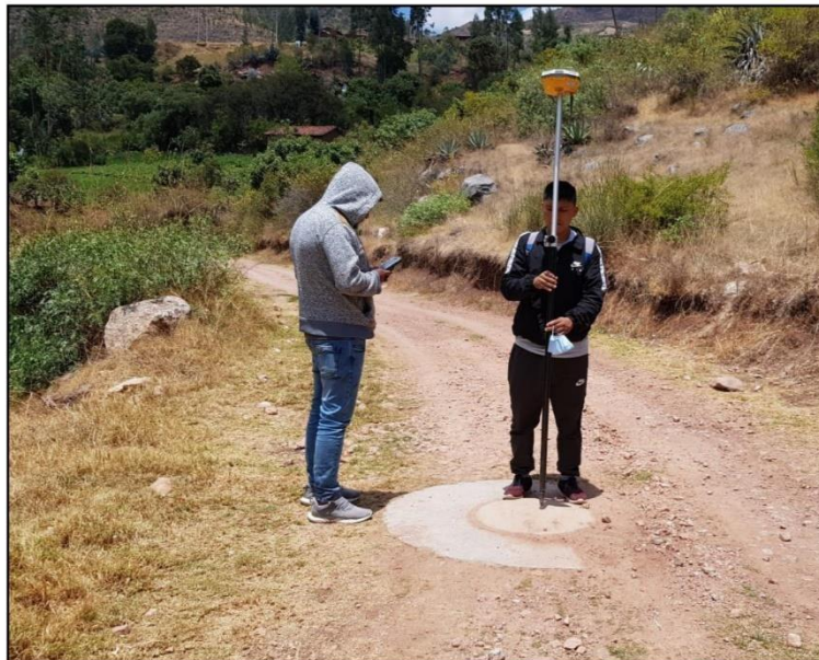
En la imagen se observa al personal técnico de topografía, realizando el levantamiento topográfico de la red colectora de alcantarillado sector del distrito de chincheros.
