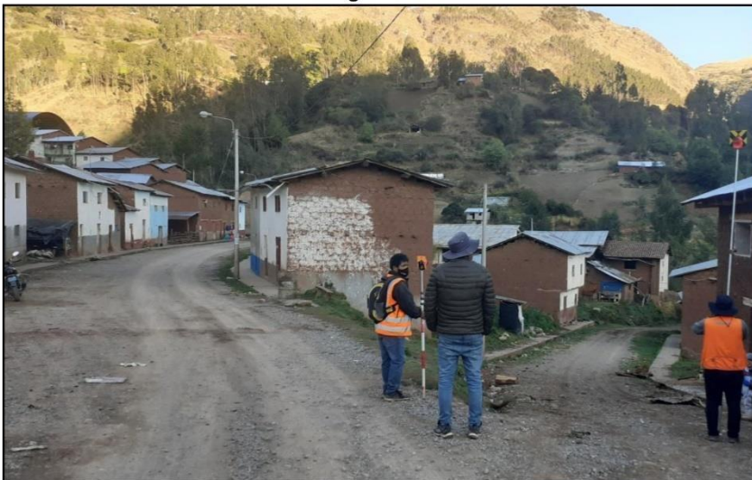
En la imagen se observa la cuadrilla de levantamiento topográfico, realizando los trabajos de levantamiento de puntos de ubicación de viviendas, calles y estructuras existentes en la localidad de Muñapucro.
