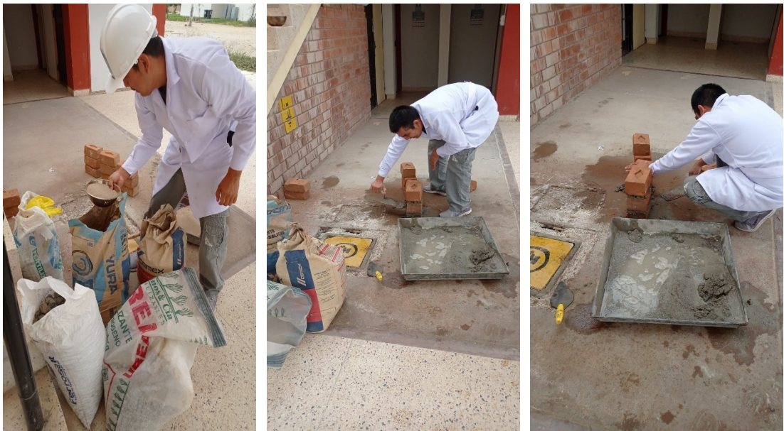
Preparación de las pilas de ladrillo artesanal, aplicando el mortero entre unidades.
